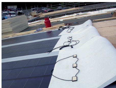
obr. 3 - Vyústění napojovacích kabelů od FV modulů na spodní straně pásů EVALON-Solar
