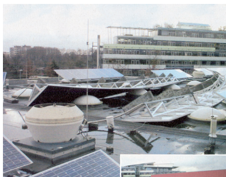
obr. 1 - Důsledek nedostatečné stabilizace stojanů s fotovoltaickými panely proti účinkům větru
