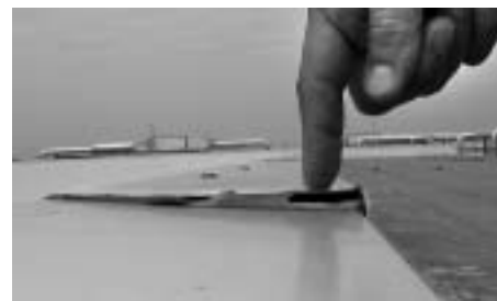
Obr. 5 Chybné provedení klempířského ukončení povlakové hydroizolace na atice.
