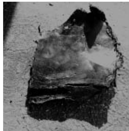
Obr. 13 Pohled na spodní líc části asfaltového souvrství, původně umístěné na oplechování bez známek penetrace
