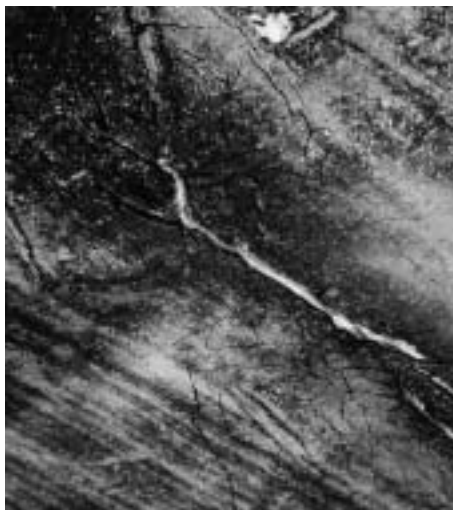
Obr. 7 Detail pásu s degradovanou horní krycí vrstvou a obnaženou nosnou vložkou pásu
