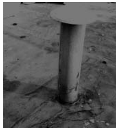
Obr. 4 Pohled na původní „odvětrávací“ komínek
