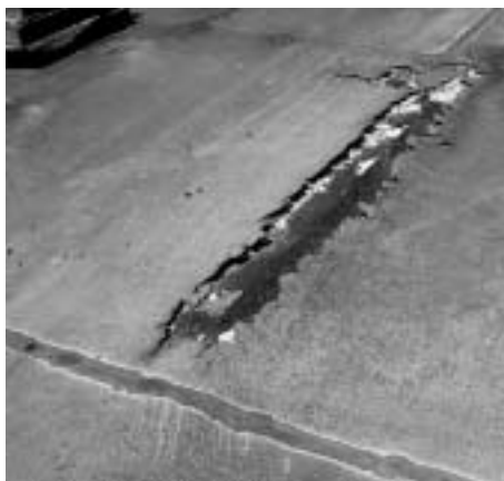
Obr. 3 Dramatická koroze titanzinkových plechů při dlouhodobém styku s asfaltem.
