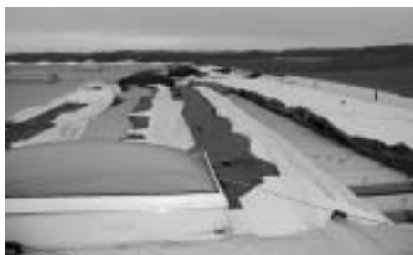
Obr. 1 Důsledek chybného řešení ukončení povlakové hydroizolace na okraji střešní plochy.
