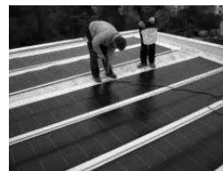
▲ Obrázek 51 ▲ Kotvení fotovoltaických panelů
